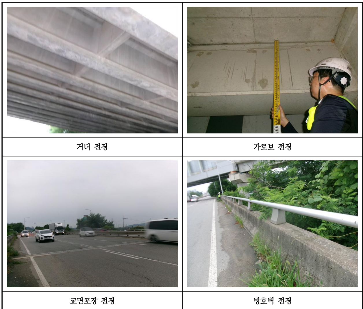
【사진 1.2.2】 상부구조 현황
